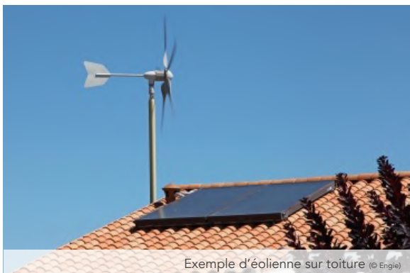
Exemple d'éolienne sur toiture (© Engie)
